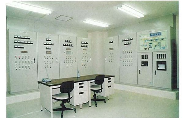
中央監視制御盤
